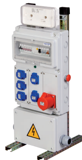
COFFRET DE DISTRIBUTION AVEC ÉCLAIRAGE DE SECOURS
